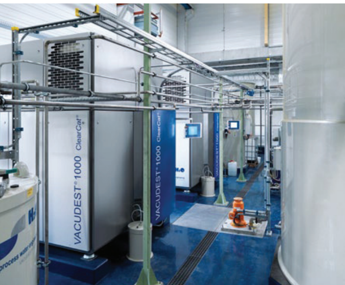
Wasseraufbereitung im geschlossenen Wasserkreislauf
